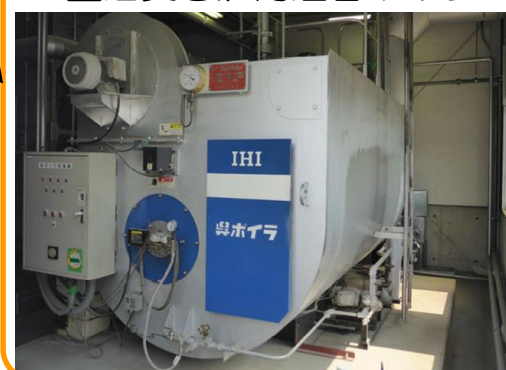
A重油焚き炉筒煙管ボイラ
